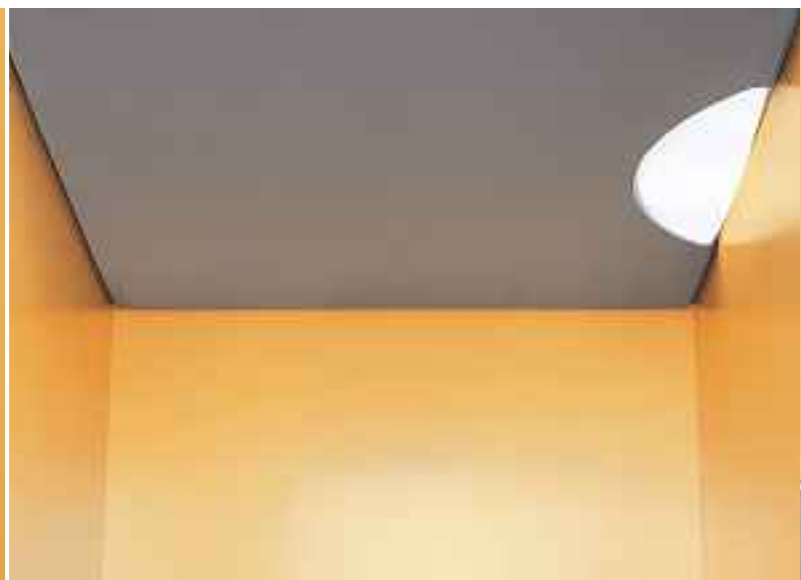
Sufitowe oświetlenie kabiny
